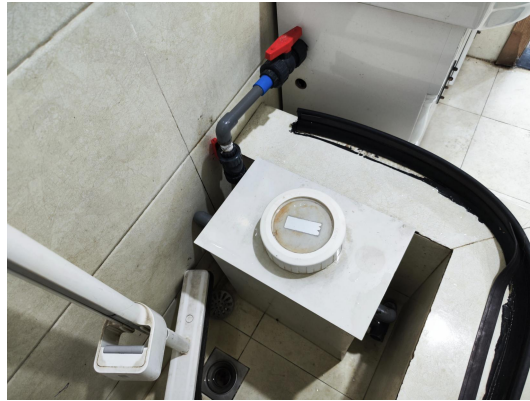
一体化污水处理设施
