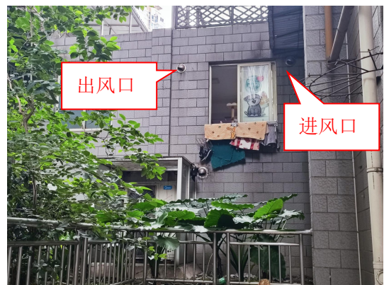
室外进、出风口
