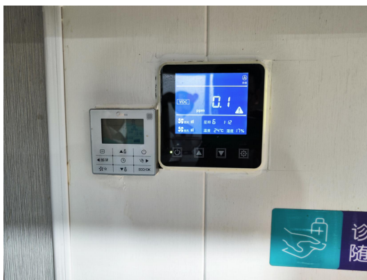
新风系统显示屏控制器
